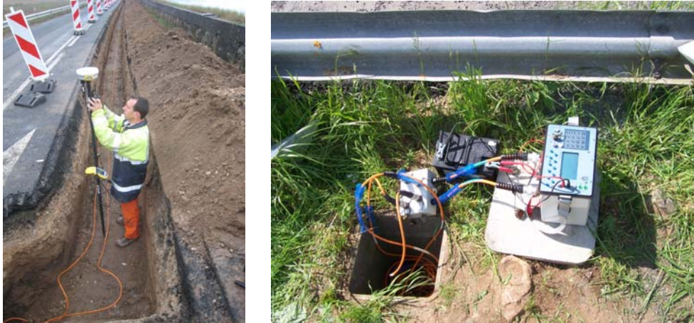
Figure 1 : Instrumentation de la digue (tranchée et repérage GPS, à gauche) et vue du système d'acquisition (à droite).
